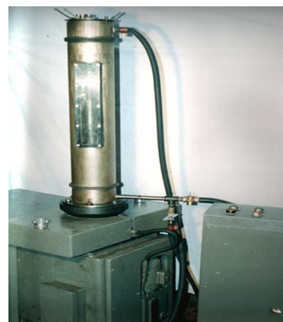
Рисунок 7. Установка для промывки фильтров
